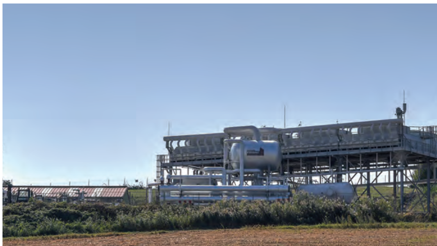
Geothermieanlage in Soultz-sous-Forêts (©Electricité de Strasbourg)
