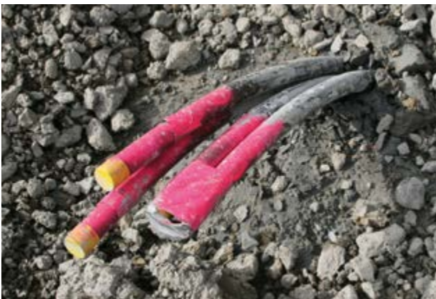
Oberes Ende einer Erdwärmesonde, vor dem Anschluß an den Wärmeträgerkreislauf
