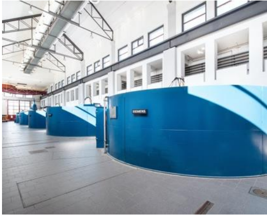
Stromproduktion im Laufwasserkraftwerk
