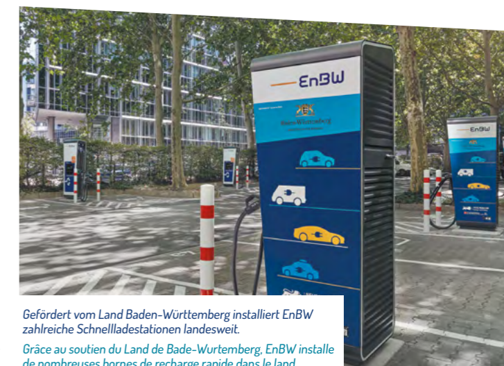
Die EnBW installiert in vielen deutschen Städten Schnellladeparks, wie hier in Karlsruhe. EnBW propose des parcs de recharge dans de nombreuses villes allemandes, comme ici, à Karlsruhe.
