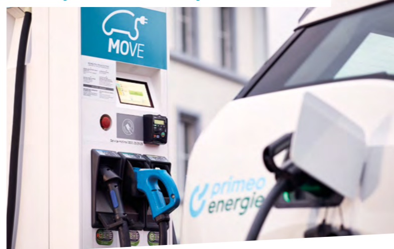
In Therwil hat Primeo Energie zwei Ladesäulen an das MOVE-Netz angeschlossen. Primeo Energie a raccordé deux bornes de recharge au réseau MOVE à Therwil.
