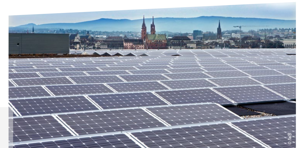
Eine der größten PV-Anlagen der Nordwestschweiz auf den Dächern der Messehalle 1 in Basel. L'une des plus grandes installations PV du nord-ouest de la Suisse sur les toits de la halle d'exposition 1 à Bâle.
