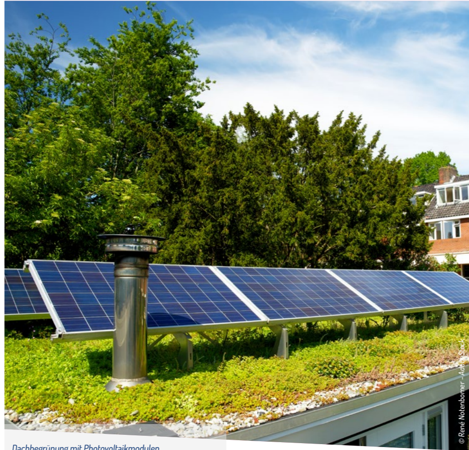
Dachbegrünung mit Photovoltaikmodulen. Toit végétalisée à panneaux photovoltaïques.
