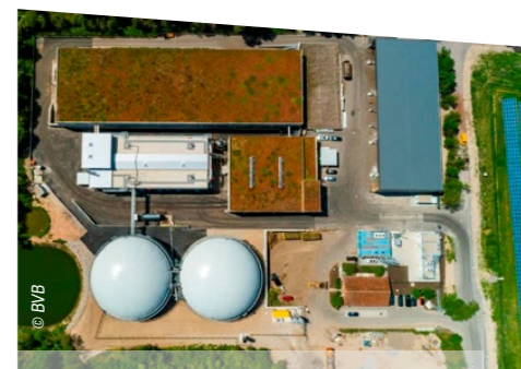
Installation de biogaz, Westheim, Biogutvergärung Bietgheim GmbH. Biogasanlage, Westheim, Biogutvergärung Bietgheim GmbH.
